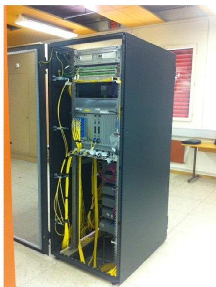
Abbildung 68 Milegate Equipment in bestehendem Rack im CO BRE
