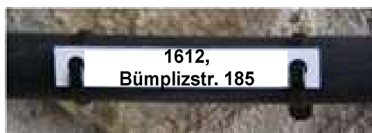
Abbildung 96 Kabelbeschriftungsschild für Drop-Kabel (bei BEP)
