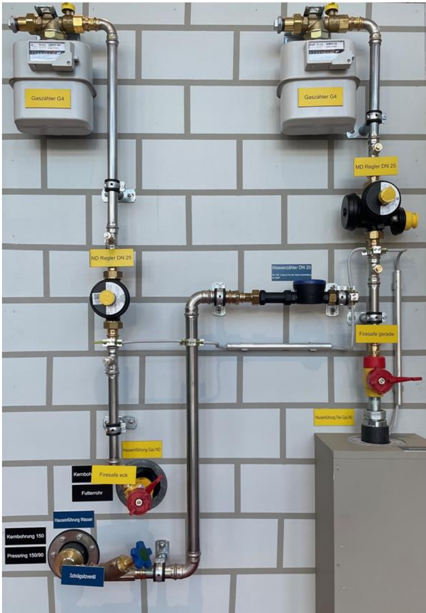
Netzanschlüsse Erdgas und Wasser
