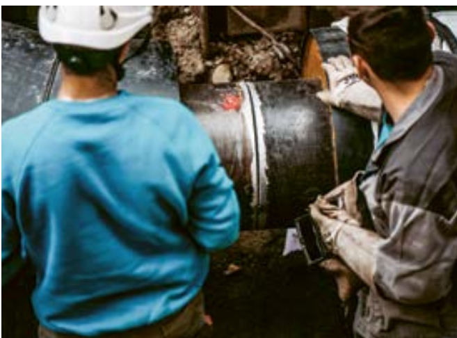
In der dicht besiedelten Stadt Bern ist das Verlegen der Fernwärmeleitungen mit ihren grossen Durchmessern eine besondere Herausforderung.
