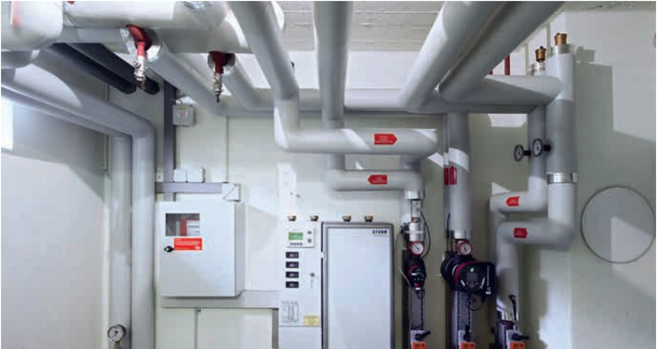
Umstellung auf Fernwärme: An der Schenkstrasse 5 wird jetzt mit nachhaltiger Wärme geheizt.
